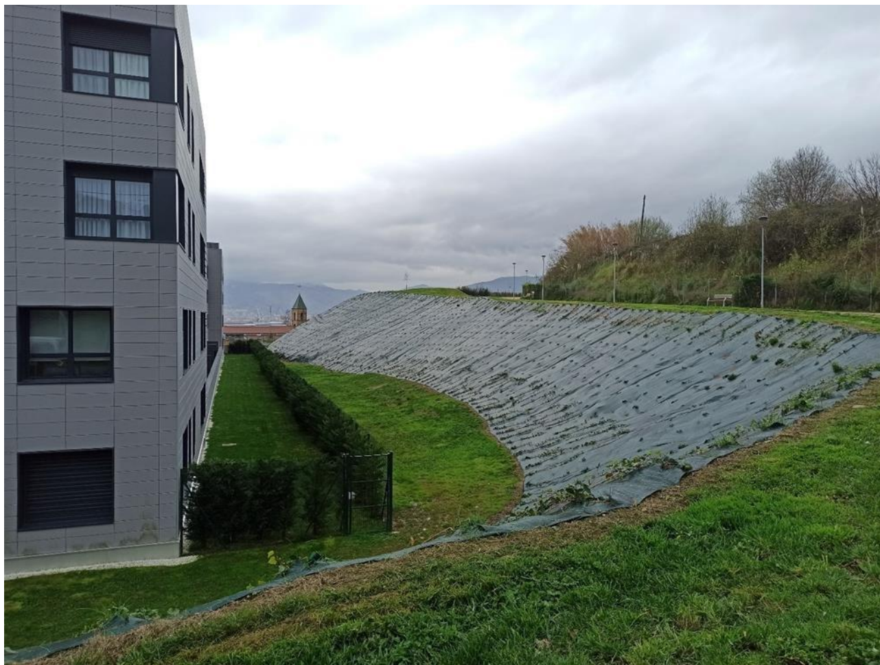
Imagen 16. Talud cubierto por geotextil perforada en proceso de plantación entre Leioagoitia y Aldekoena.
